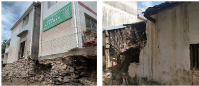
地基不稳定产生明显滑移，出现局部或整体沉陷
