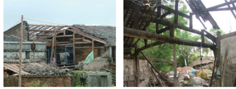
吹落屋面瓦片
