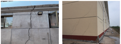
承重墙开裂，单条裂缝宽度大于10mm，或单道墙体产生多条宽度大于5mm的裂缝
